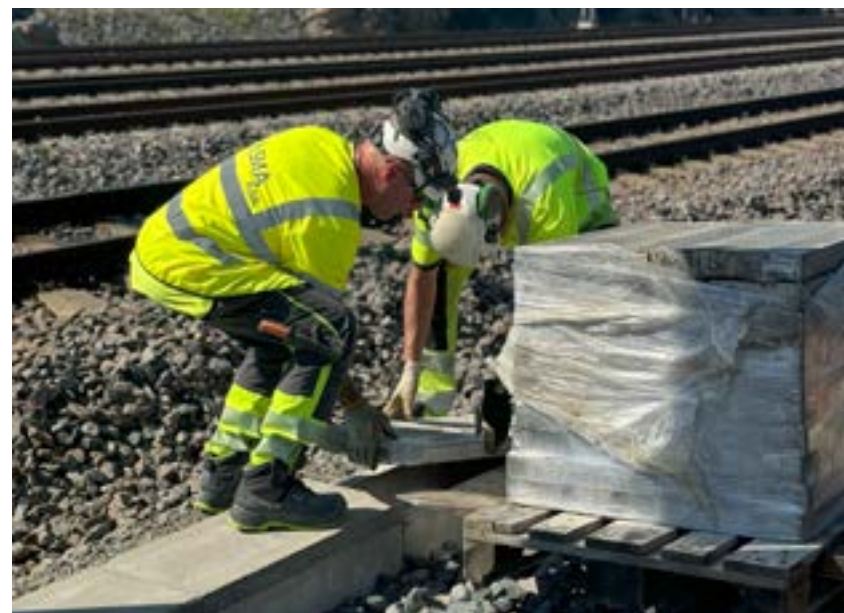
Lockning av kabelränna.
