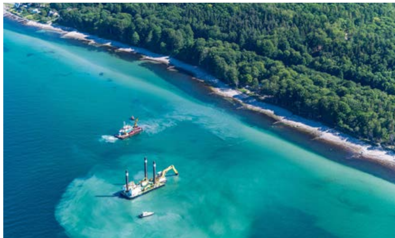
Själland är anslutet till södra Sverige med fyra elförbindelser. Bild från när den andra så kallade System 1-förbindelsen byttes ut under 2020. Foto: Energinet
